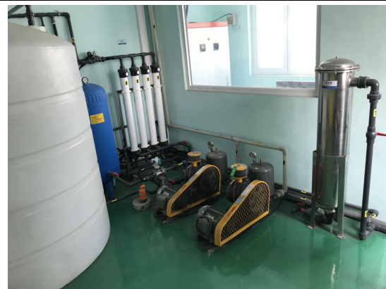
图 6 增氧机、超滤器等设备
